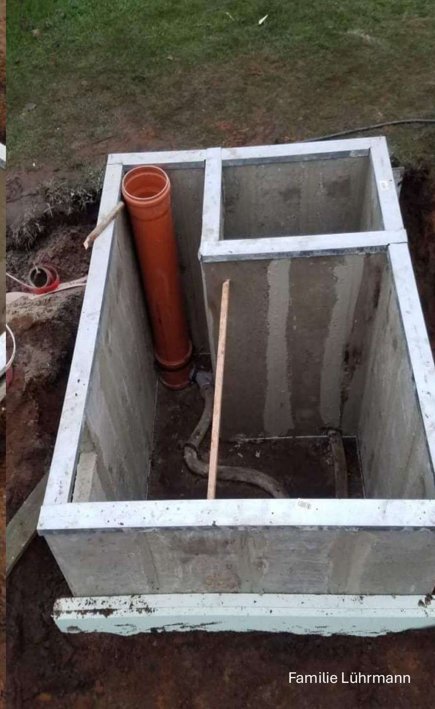
Drainagerohr und KG Rohr für die Pumpe.
